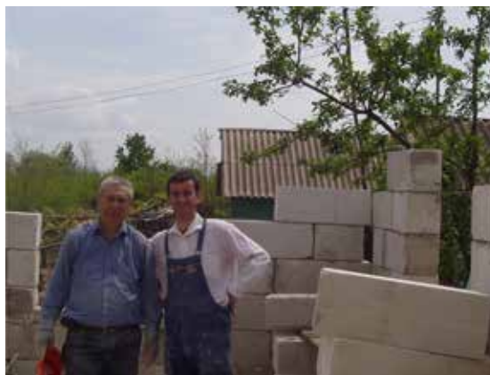
Broșteanu (kék ingben) George Aroiu szociális gondozóval együtt segít egy volt feyenc házának építésében.
